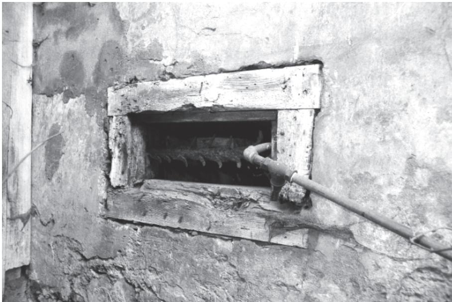
Abb. 60: Wohnhaus, Keller 03, Detail: Luzide in Holzge- wände; Ansicht an der Wohnhaus-Nordfassade. Neg. Nr. 2.23
